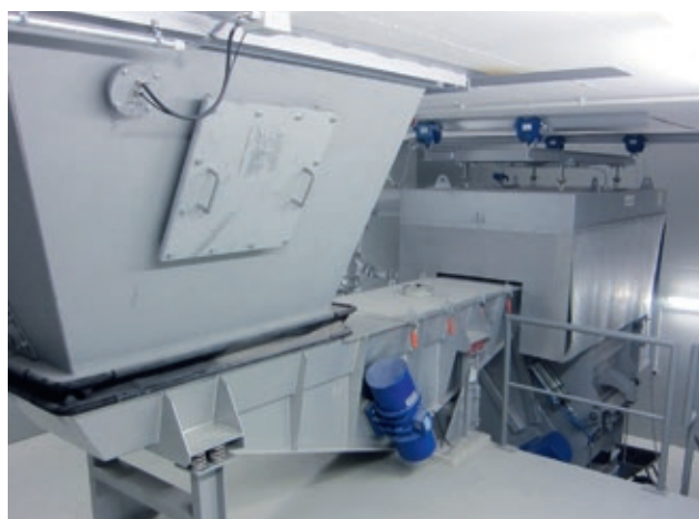
位于落砂栅格下方的砂斗，震动输送机，磁选及震动破碎机 Zesyp pod kratą wstrząsową, podajnik wibracyjny, separator magnetyczny oraz kruszarka wibracyjna wybitej masy formierskiej
