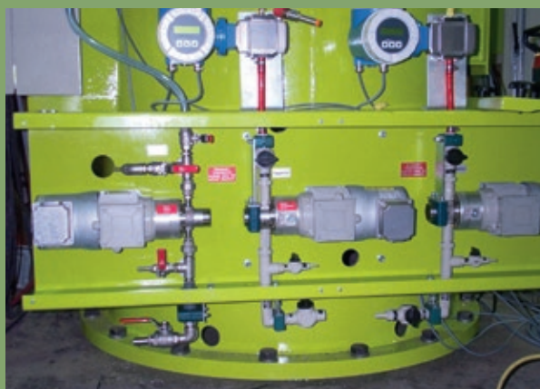
装有磁力泵及流量计 (Duomix) 的粘结剂定量给料系统 Dozowanie środka wiążącego przez pompy ze sprzęgłem magnetycznym; pompy wyposażone w przepływomierze (system Duomix)
