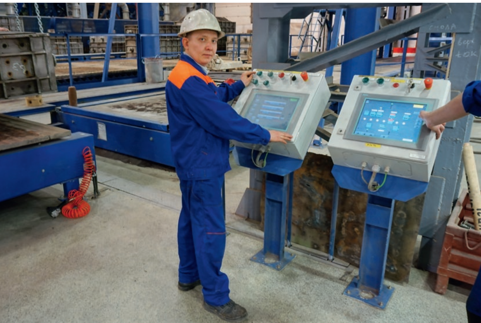
带有操作面板的控制柜 Szafa sterownicza z panelem obsługowym
