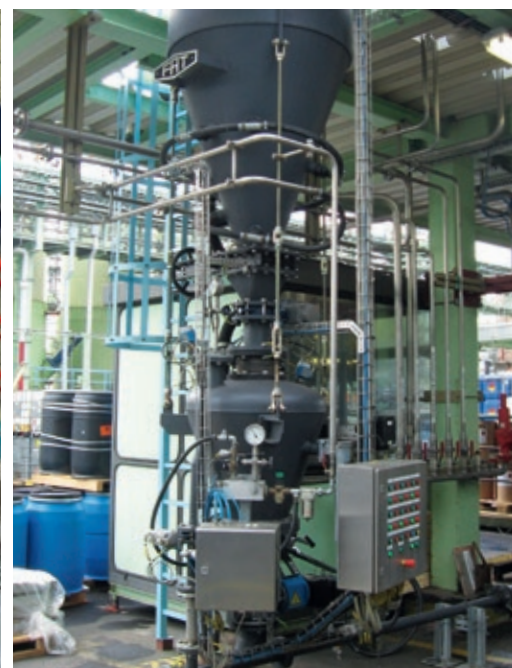
定量和气化装置 Instalacja dozowania i wdmuchiwania
