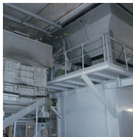
落砂系统及设备配重 Stanowisko wybijania odlewów; kratą wstrząsową z przeciwbieżną masą
