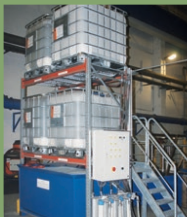
液料罐系统及粘结剂过滤系统 Kontener środka wiążącego z wanną wychytującą obcieki i filtrem środka wiążącego
